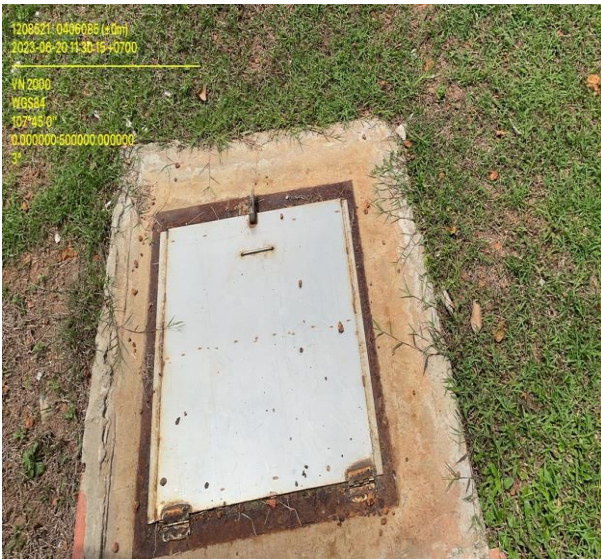
Hình ảnh hố ga đầu nối nước thải dẹt và sinh hoạt
