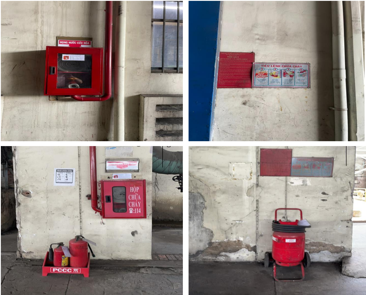
Hình 3.5. Hình ảnh hệ thống PCCC tại dự án
