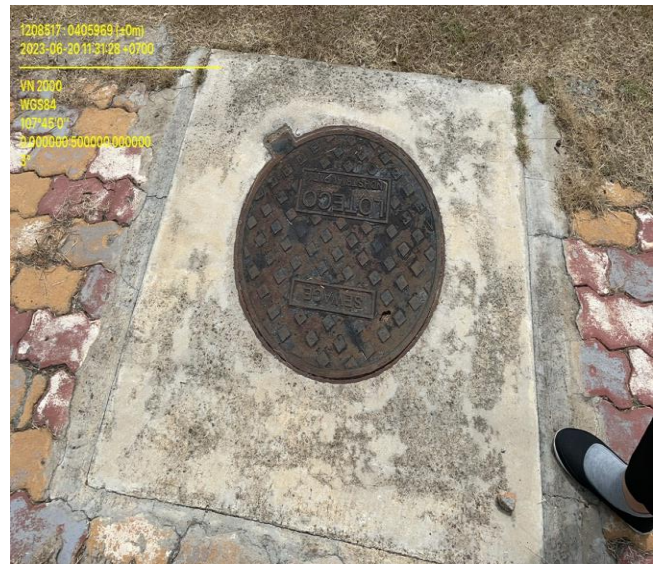
Hố gas đầu nối nước thải sản xuất
