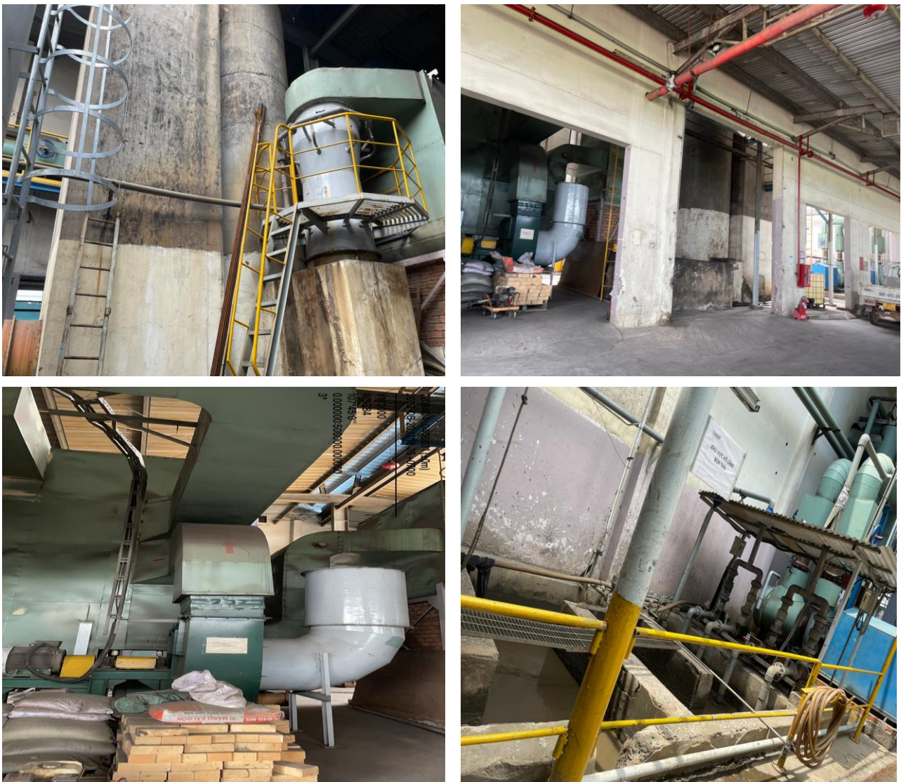
Hình 3.4. Hình ảnh hệ thống xử lý khí thải lò hơi, lò dầu tải nhiệt
